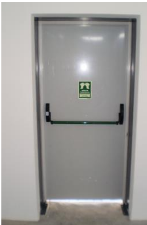
Figura 4- Porta de Emergência Corta Fogo
