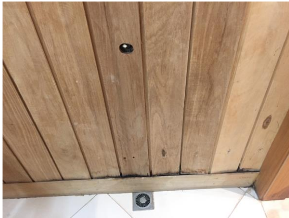
Figura 10 - Peças de madeira a serem substituídas na Sauna
