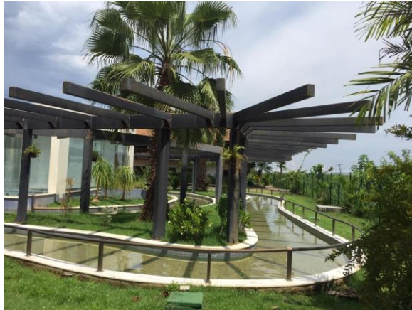
Figura 4 - Corrimãos devem ser reafixados e receberão pintura nova
