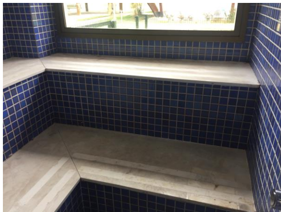
Figura 11 - Banquetas de mármore a serem substituídas
