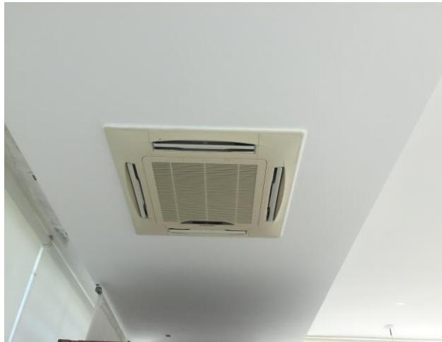
Figura 5 - Forro de gesso a ser recomposto
