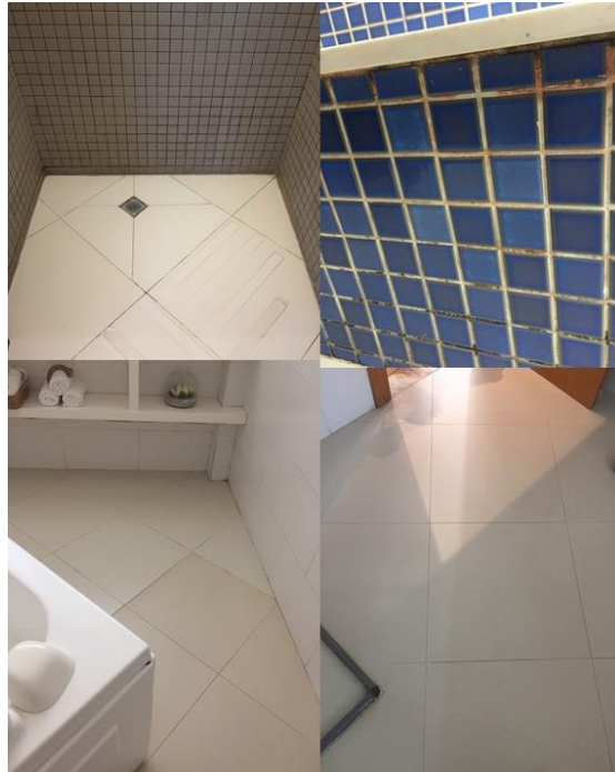
Figura 8 - Todos os rejuntas devem ser refeitos
