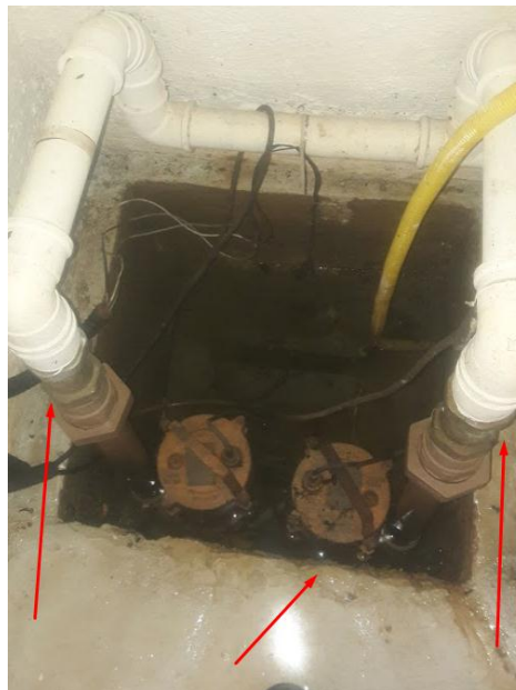
Imagem 05 – Poço de Infiltração com excesso de água.
