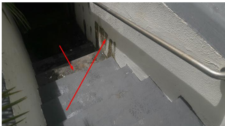
Imagem 01 – infiltração na escada de acesso.
