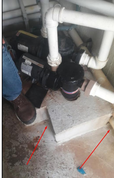
Imagem 04 – Piso interno com acúmulo de água.
