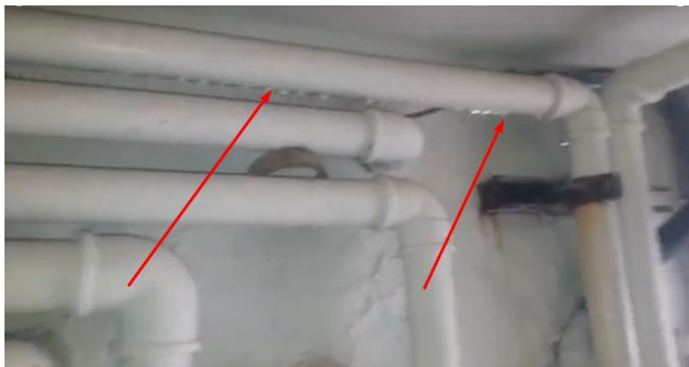
Imagem 02 – Tubulações hidráulicas com umidade.
