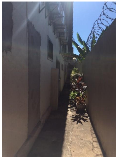
Figura 3 - Corredor com drenos a serem regularizados
